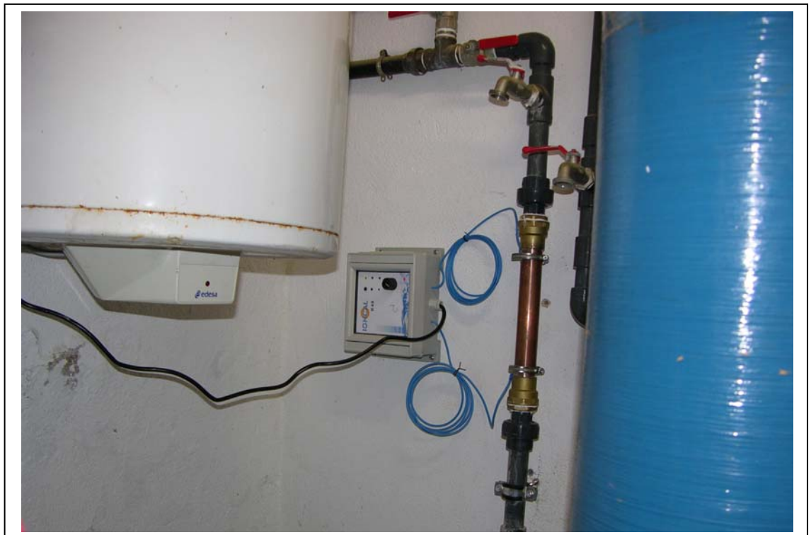
Barbacoa La Pesquera, Marbella. Málaga. Julio 2009 Detalle de anti-incrustante IONCAL E-63 montado sobre pieza pre-fabricada en tubo de Ø 35 mm. de cobre e intercalada en tubería de PVC Ø 32 mm de línea de entrada a sistema de potabilización de aguas.
