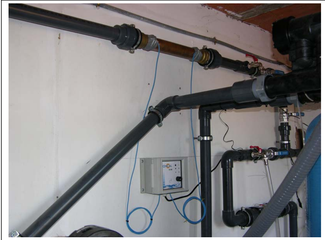
Finca El Soto de las Salcedas, Casas de Obreros. Ciudad Real. Octubre 2008 Detalle de anti-incrustante IONCAL E-63 montado sobre pieza pre-fabricada en tubo de Ø 54 mm. de cobre e intercalada en tubería de PVC Ø 50 mm de línea de entrada a sistema de potabilización de aguas.
