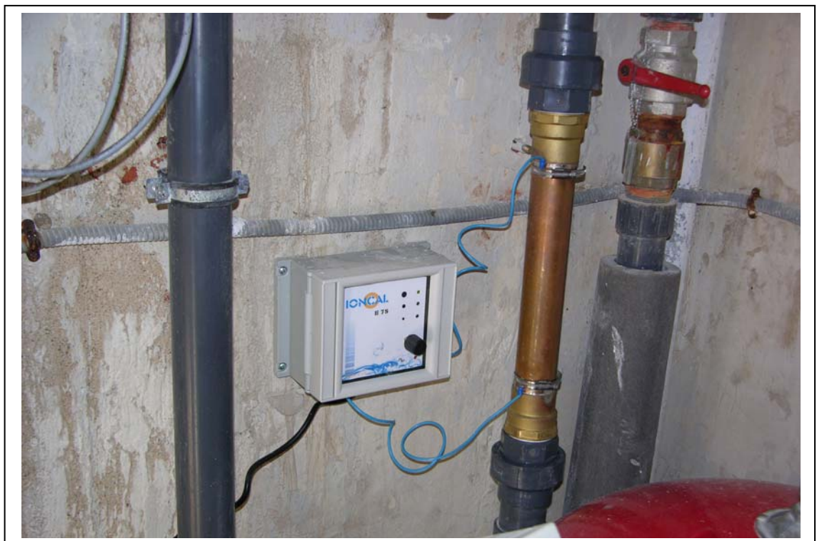
Finca El Soto de las Salcedas, Casa Principal. Ciudad Real Diciembre 2007. Detalle de anti-incrustante IONCAL E-75 montado sobre pieza pre-fabricada en tubo de Ø 54 mm. de cobre e intercalada en tubería de PVC Ø 63 mm de línea de entrada a sistema de potabilización de aguas.
