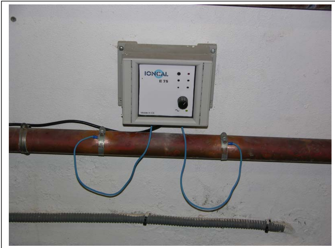
La Barraca Valenciana de La Pesquera. La Línea. Cádiz Julio 2005 Detalle de Anti-incrustante IONCAL E-75 montado sobre tubería Ø 54 mm de cobre en línea de salida de agua a consumo del restaurante.
